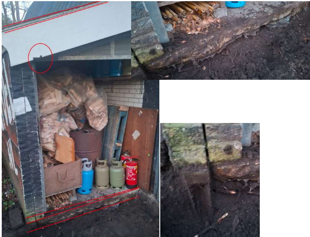
Open gegraven straatzijde met onregelmatige betonvloer en verzakking, detail van de hoek met paalhouder.
