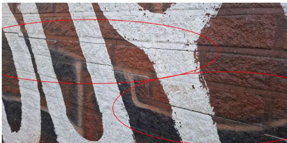
Horizontale scheuren in de voeg over de gehele lengte van het piohok
