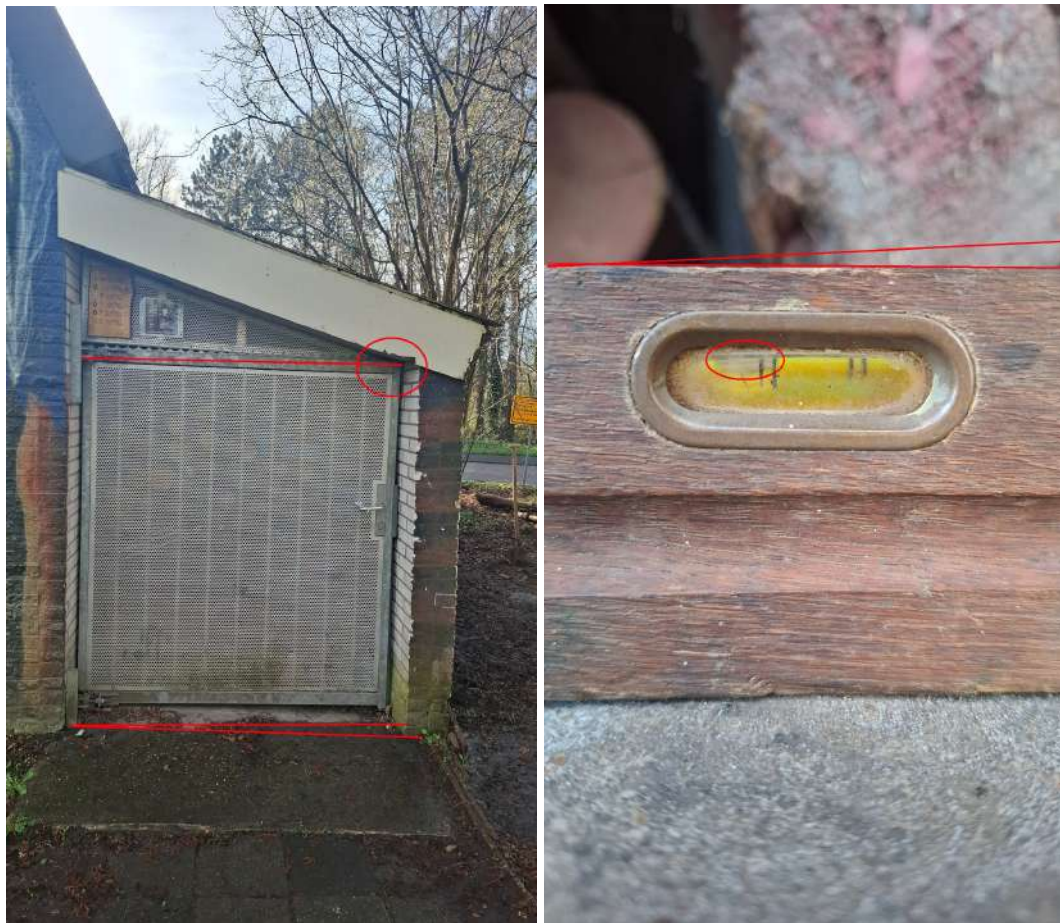
De verzakking gezien vanaf veldzijde, rode lijnen ter indicatie. Waterpas voor scheefstand.
