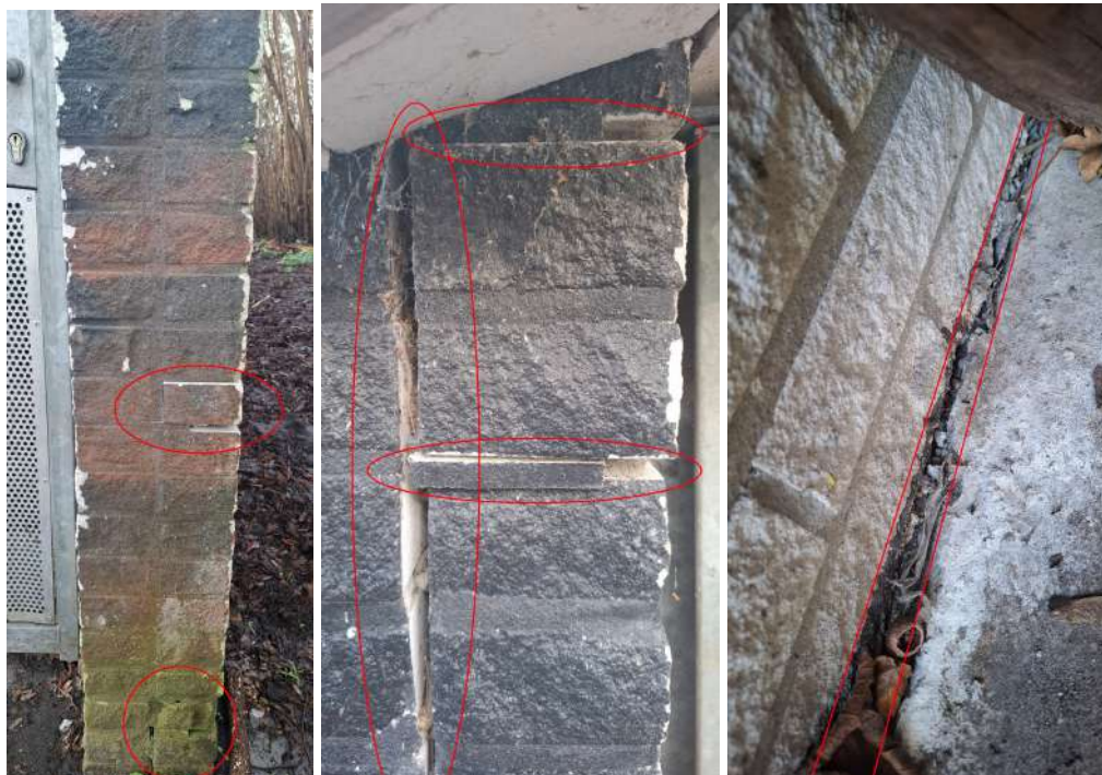
Scheuren op de kopse kanten van de muur aan beide zijden en langs de buitenmuur van het gebouw (binnenmuur piohok)
